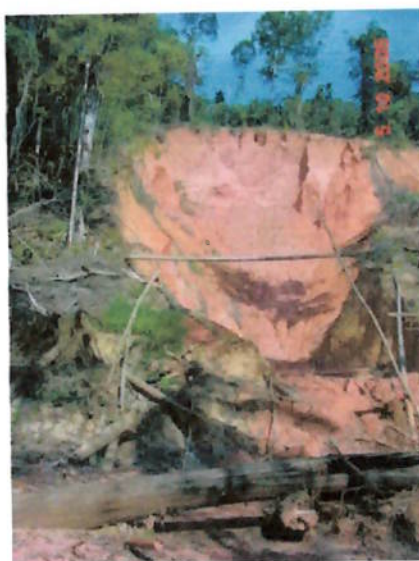
Figura 14 – Local da ocorrência da erosão. Fonte: Relatório de investigação de acidente da Mavefer Engenharia, 2005.
